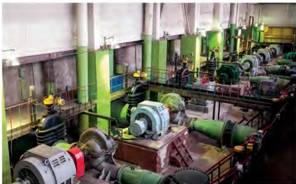
Третья насосная станция очистных сооружений собирает очищенные стоки ТОАЗа, КАТЗ, Волжских коммунальных систем. В 2018 году с целью сокращения затрат на электроэнергию планируется установка нового эффективного насоса
