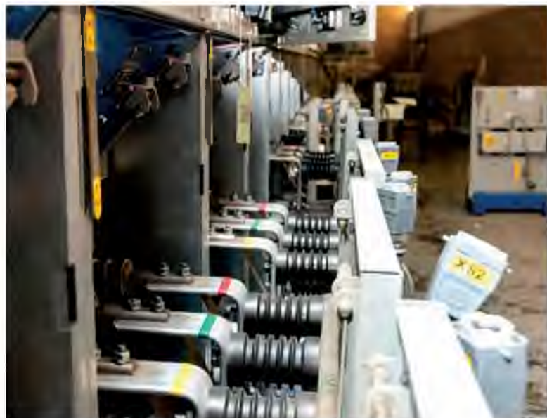
Замена щитов на подстанции карбамида в цехе №8 обеспечит надёжную, бесперебойную работу оборудования
