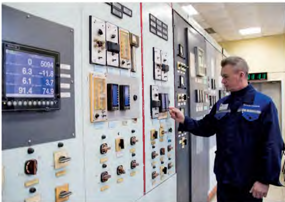
Реконструкция оборудования КИПиА в цехе №19 позволит вести работу котлоагрегатов в автоматическом режиме, что обеспечит экономию природного газа
